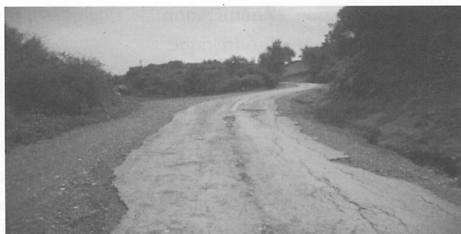
Photo 1: Route goudronnée en dégradation (région Taounate)
