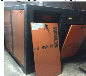
الصورة (7) توضح منظر لمضخة توليد هواء القطع للماكينة
