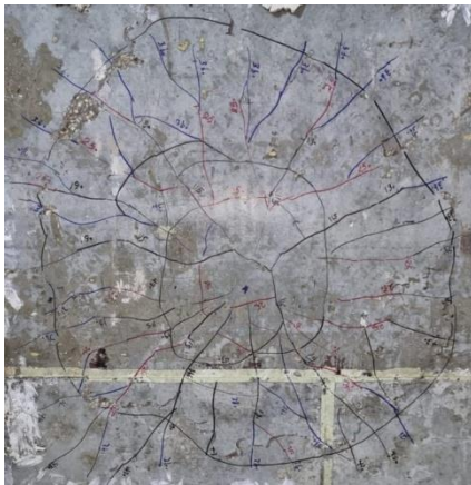
(d) Crack patterns of S4
