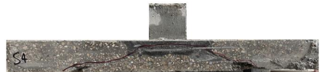
(d) Crack patterns of S4
